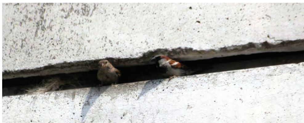
Fot. 38. Wróble gniazdujące w szczelinie dylatacyjnej (AT)
