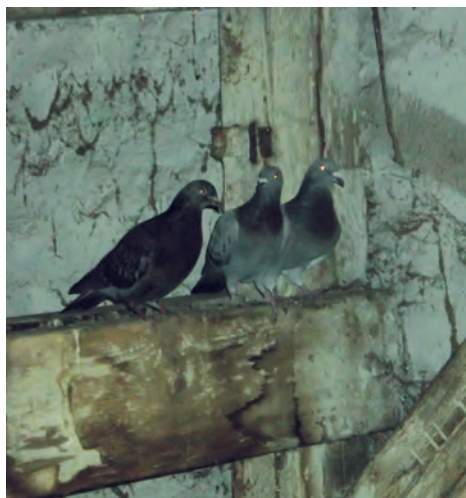
Fot. 68. Gołębie miejskie zasiedlające strych (DZ)
