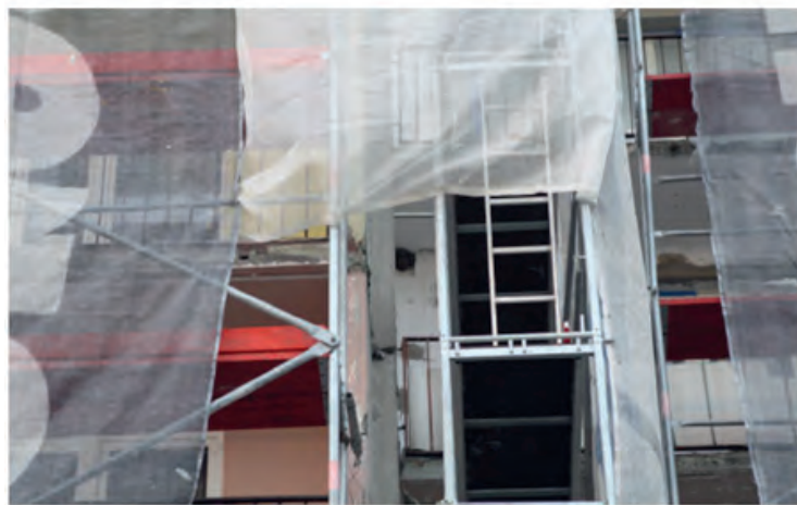
Fot. 1. Gniazdo oknówki uwiecznione między rusztowaniami. Budynek ul. Pultusk.
